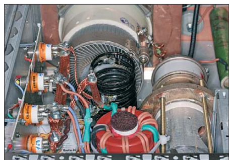
Bild 4: Pi-Filter mit gestockten Ringkernen T300-2 in einer GU43B-Endstufe; die Kerne sind mit hochspannungsfesten Silikonkautschukdrähten bewickelt. Vorn links befindet sich der Bandwahlschalter mit fünf Siemens-Vakuumrelais VR411, rechts ist ein Vakuumdrehkondensator zu sehen.
